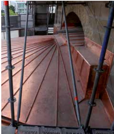
Neue Kupferabdeckungen schützen die Turmruine vor Regen und Feuchtigkeit.
